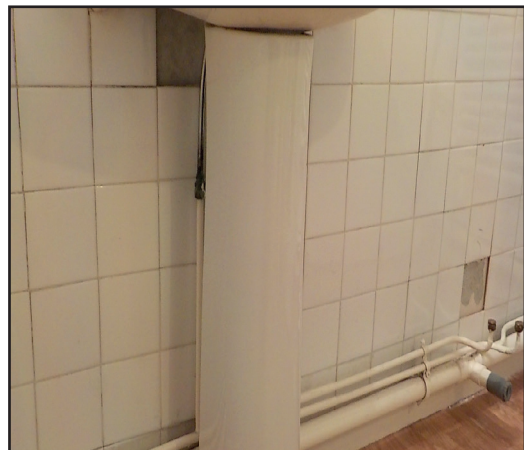
Colle amiantée sous faïence
