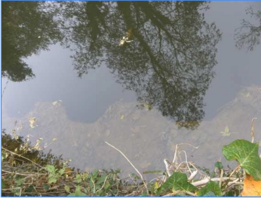
Vue des palplanches qui seront visibles suite à l'abaissement du niveau d'eau. Un rideau d'enrochement est proposé pour habiller ces palplanches.
