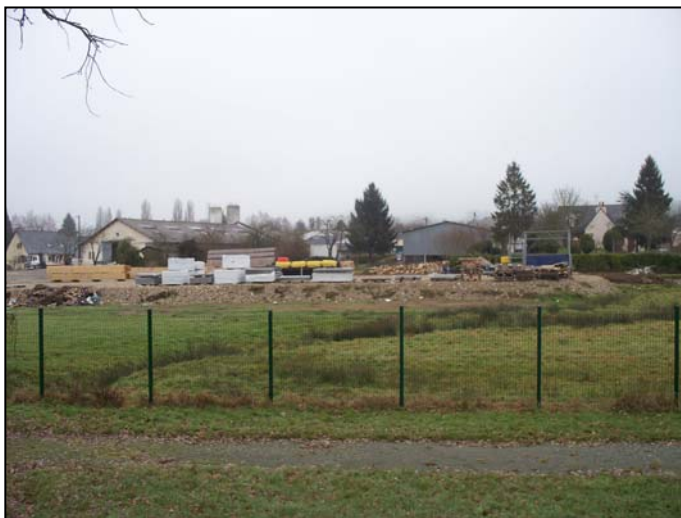
Photo 8 : Vue de la plaine alluviale rive droite en aval de l'étang et remblai en ZI
