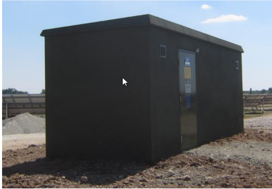
Figure 17 : Exemple de poste de conversion « indoor »
