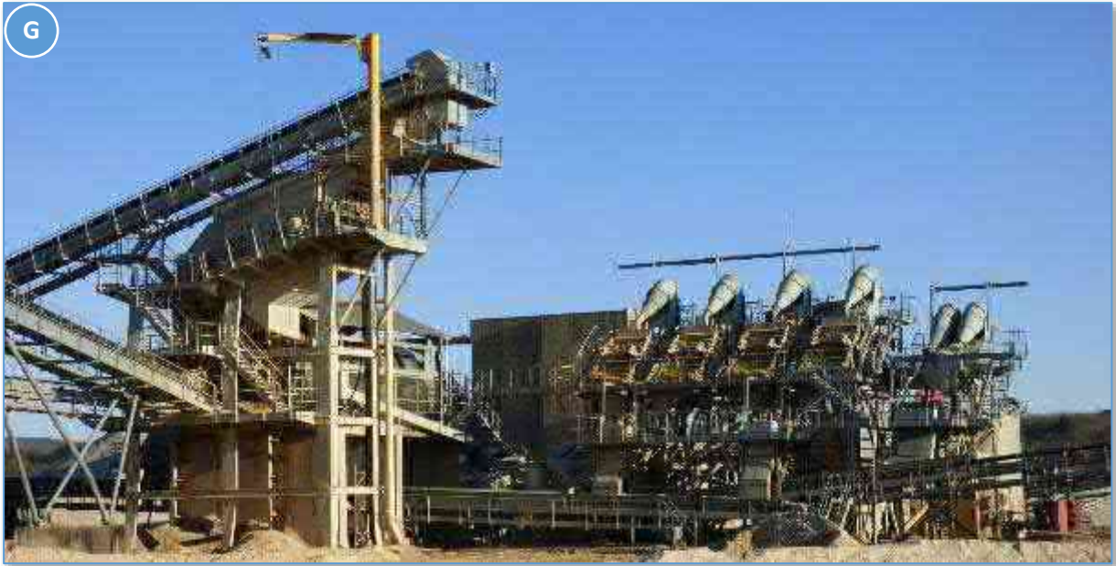
Fig. 24 : Vue sur les installations de criblage-lavage
