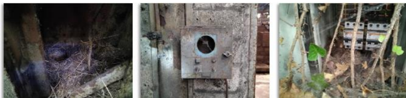
Nids dissimulés dans des boîtiers électriques, bâtiment n° 17
