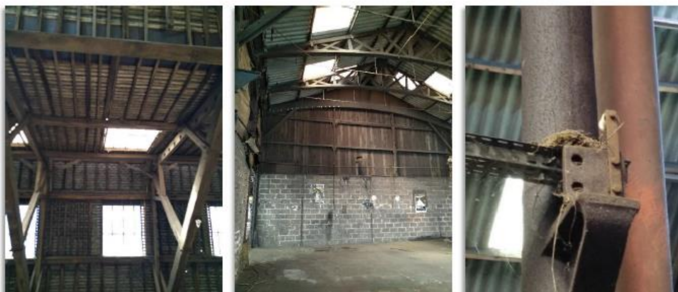
Nids en charpentes, bâtiments n° 18, 20, 21
